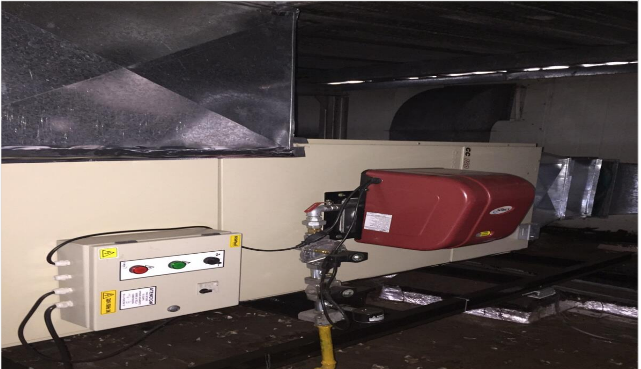
Nuevos calefactores de aire en pileta cubierta
